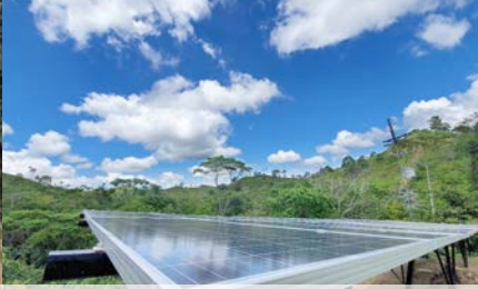
Sistema de bombeo de agua a través de energía solar
